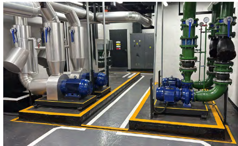
Central de água gelada no Iguatemi Esplanada
