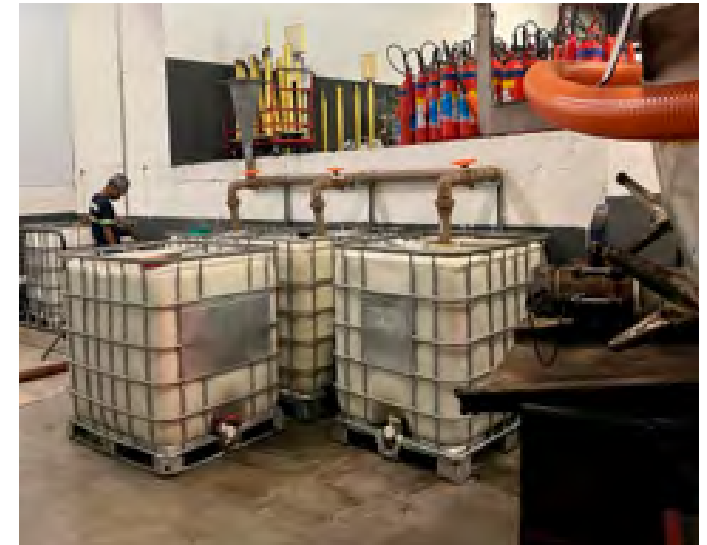
Bombas de armazenamento do tratamento de resíduo de cera
